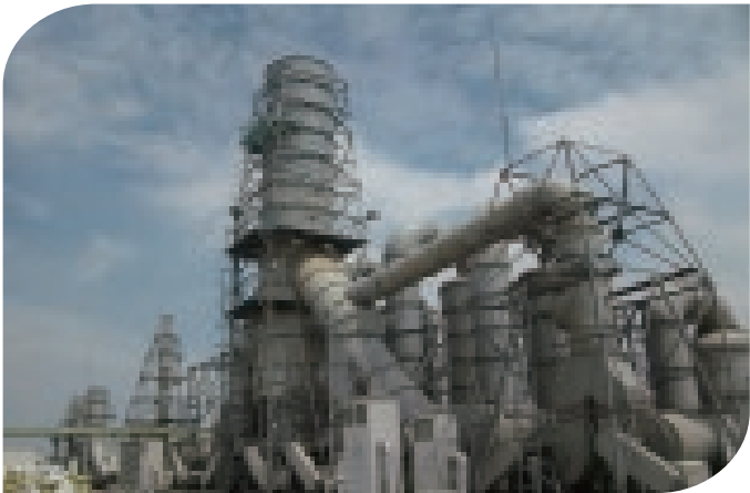
酸性废气净化塔
