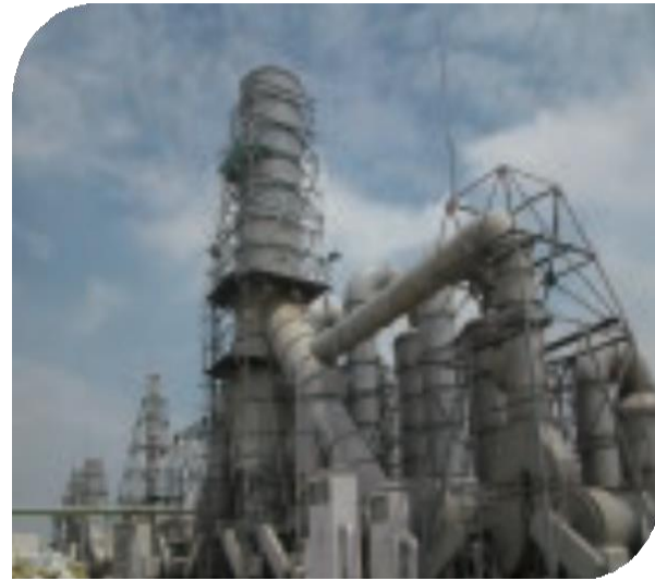
酸性/腐食性成分洗浄塔
