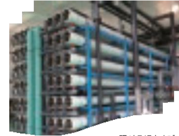
限外ろ過および 逆浸透装置
