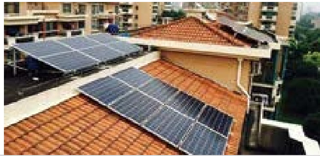
上海のモデル住宅の屋根に設置されたトリナ・ソーラーのモジュール
