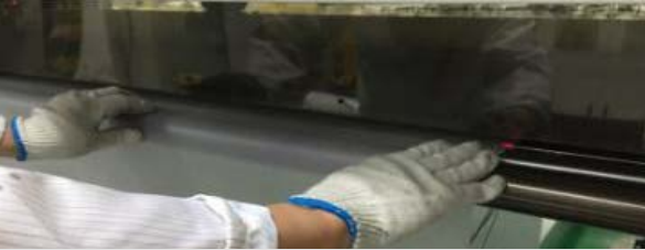
改造后增加防护挡板 防止手部进入滚轮内侧被压伤
