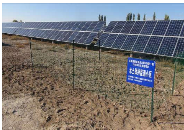
光伏系统区水土保持监测点
